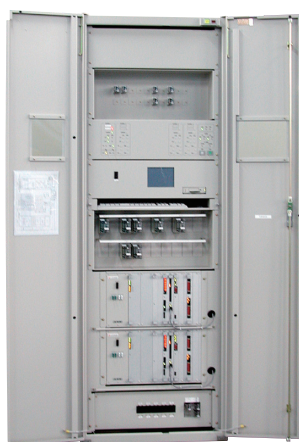
侵入検知装置 列車検知架
