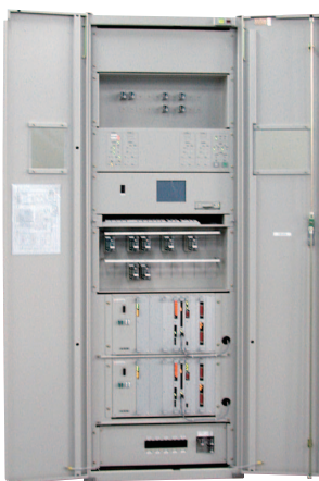
侵入検知装置 列車検知架
