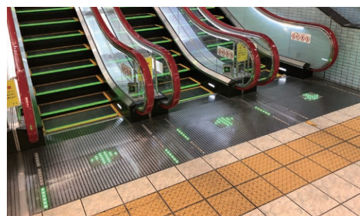
京急羽田空港国内線ターミナル駅 エスカレータ進行方向誘導灯
